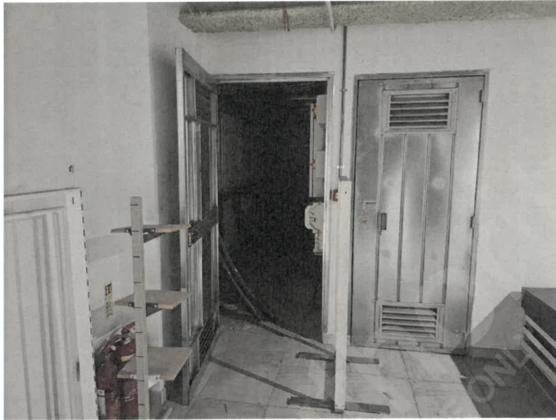
7: Ritratti ta' parti mill-imhazen li qed tintusa bhala plant room li ttiehed nhar It-Tnejn, 20 ta' Jannar 2025
